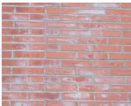
Esempio di parete in mattoni faccia vista con efflorescenze in atto; in tal caso un trattamento con Pulicem sarà risolutivo
